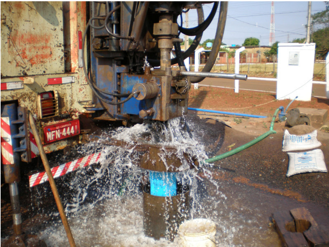
Poço tubular profundo
